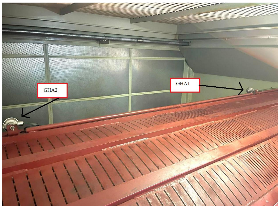
محل نصب سنسورهای اندازه گیری دمای هوای داغ ژنراتور
