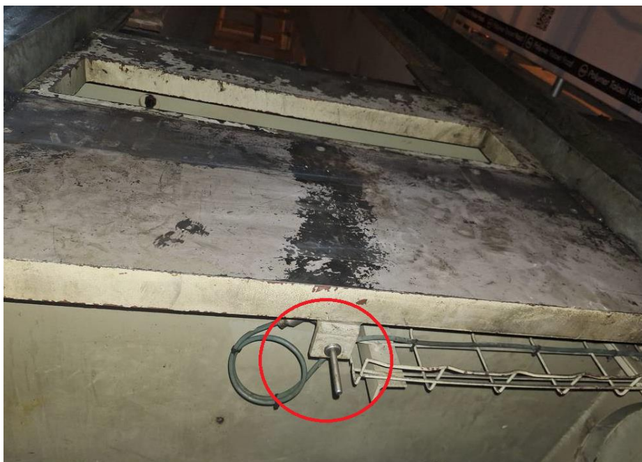
محل نصب سنسور اندازه گیری دمای هوای تحریک ژنراتور (زیر کوپه تحریک)
