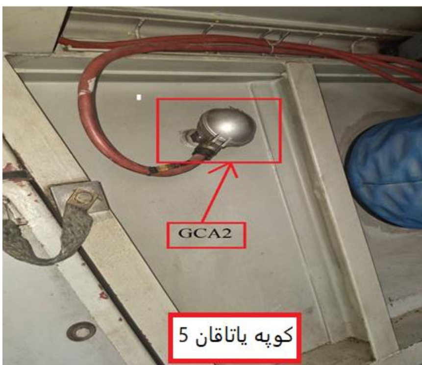
محل نصب سنسورهای اندازه گیری دمای هوای خنک ژنراتور
