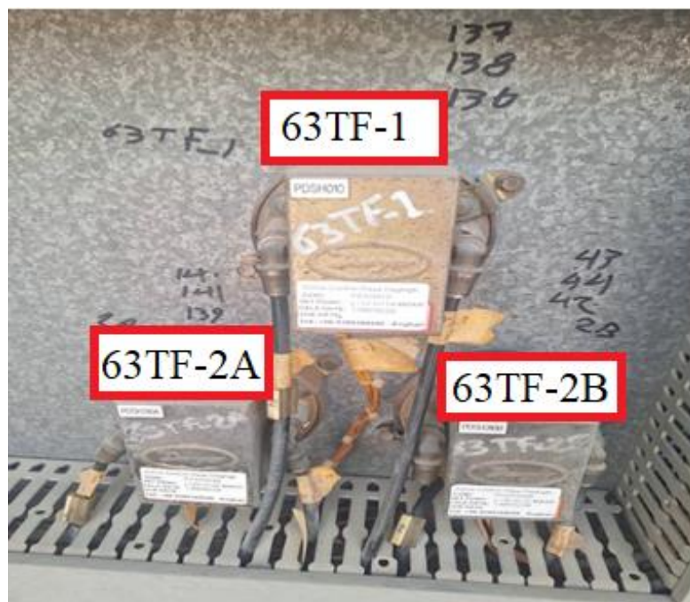
محل نصب سوئیچ های \Delta P ، از نمای نزدیک
