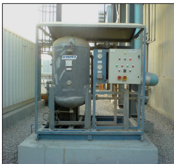
سیستم تمیز کننده فیلتر کارتریجها
