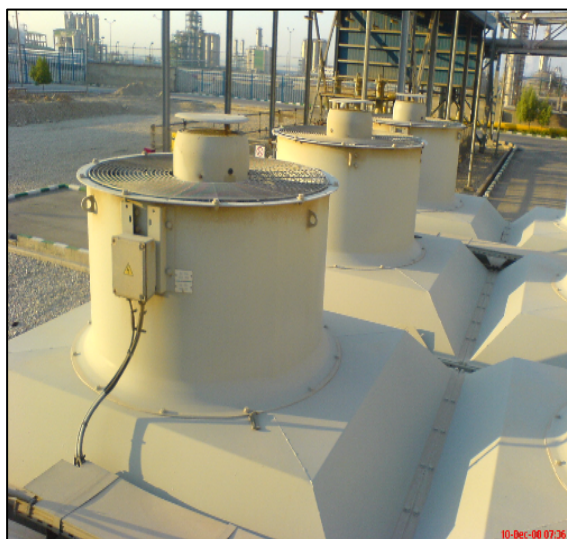
Fin fan cooler
