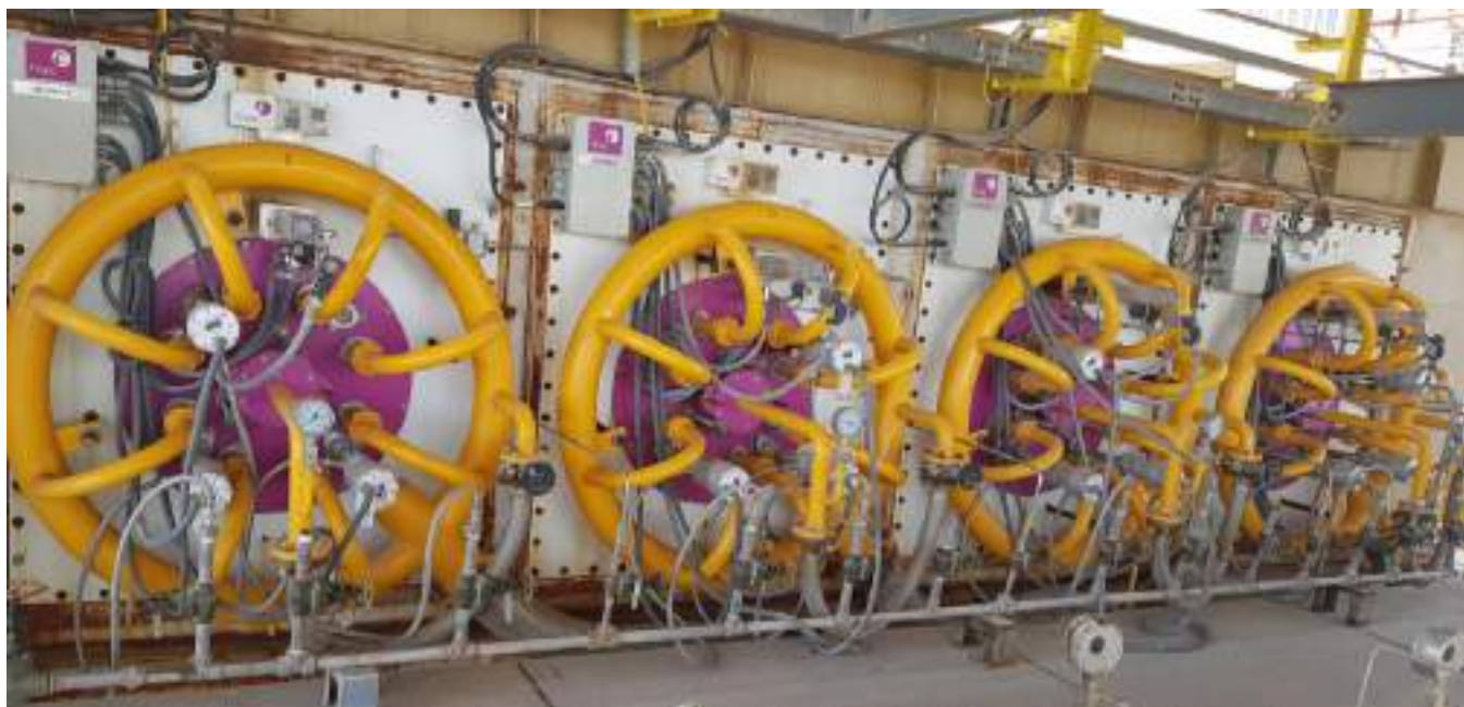
نمای بیرونی و داخلی برنرها
